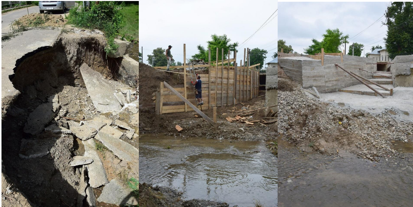
Figură 42: Imagini cu podul rutier de lângă școală după viitură și din timpul consolidării acestuia – „Fenomenele hidrometeorologice din data de 18 iunie 2016 au lăsat urme adânci în satul Borșeni unde a fost afectată grav structura rutieră lângă podul dinspre școală” (sursă foto și informații: https://www.facebook.com/comunarazboieni )
